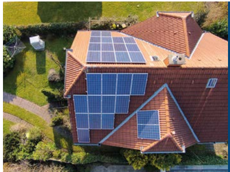
Solarthermiekollektoren auf dem Dach
