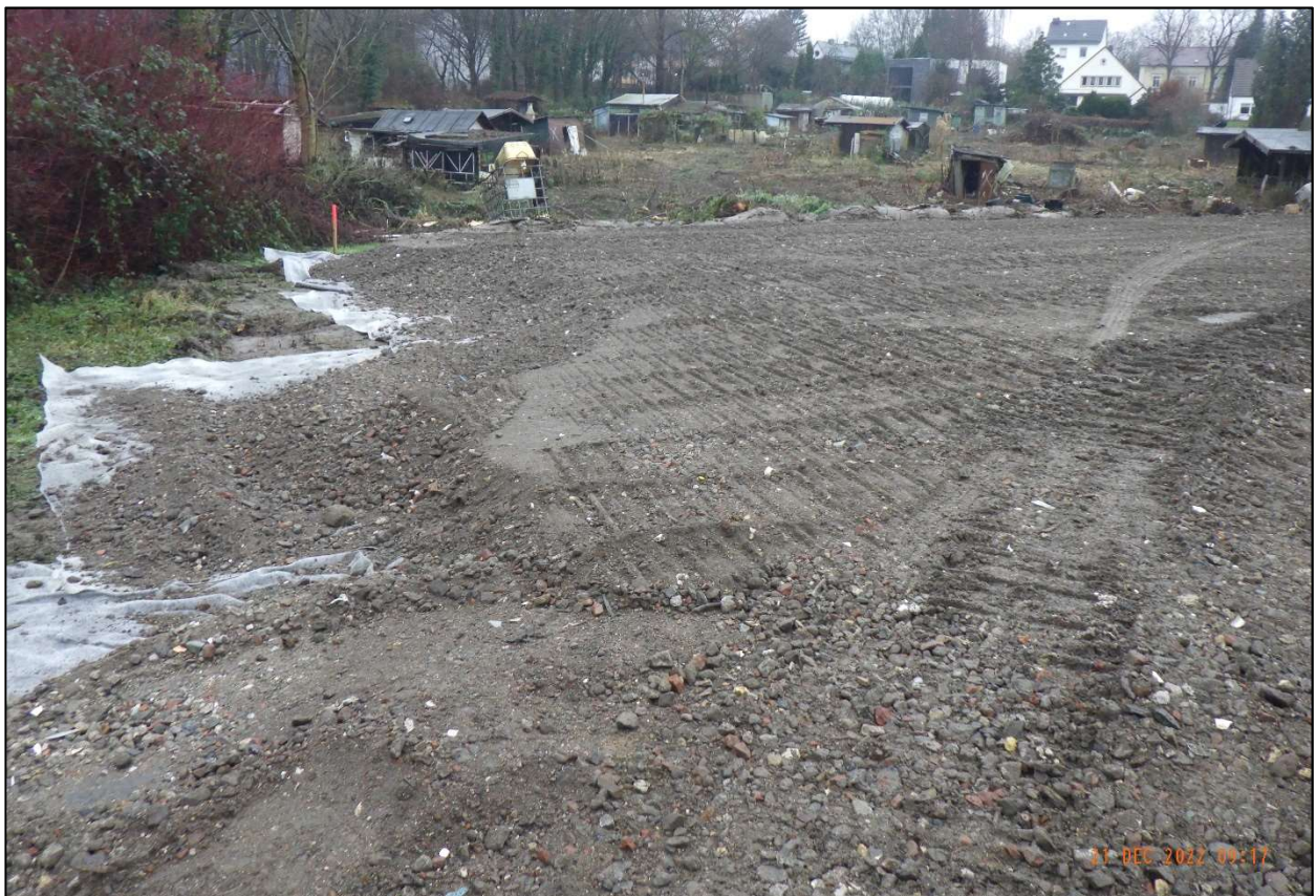
Abb. 2: Teilweise geringer randlicher Vliesüberstand; Durch Lage auf Altablagerung vernachlässigbar.
