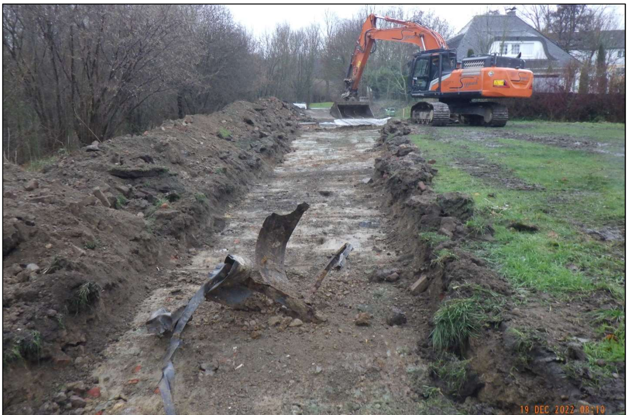
Abb. 2: Freigelegte Altlast; Ab diesem Zeitpunkt wurde auf Substratabtrag verzichtet.
