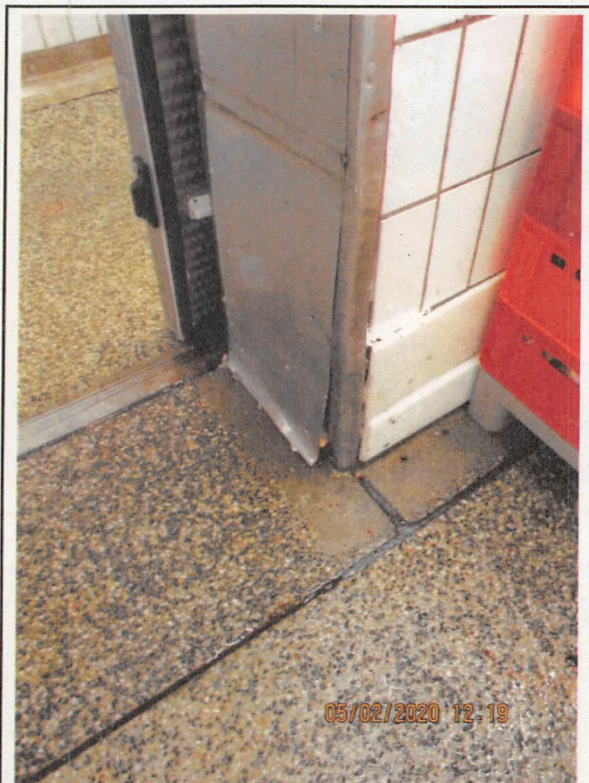
Alter „Zweier“: Blech an der Türzarge beschädigt
