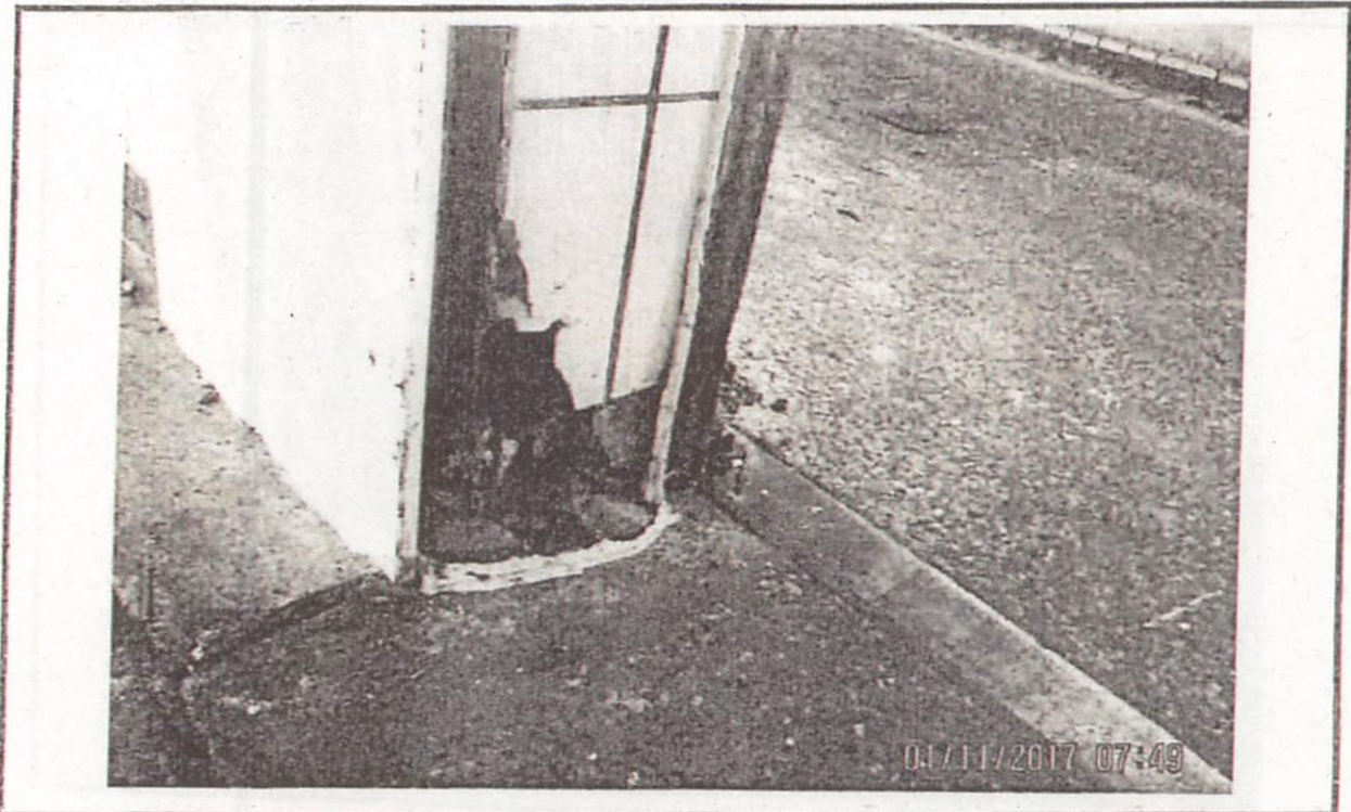
Defekte Fliesen und defekte Hohlkehle im Kühlraum für Nebenprodukte der Schlachtung
