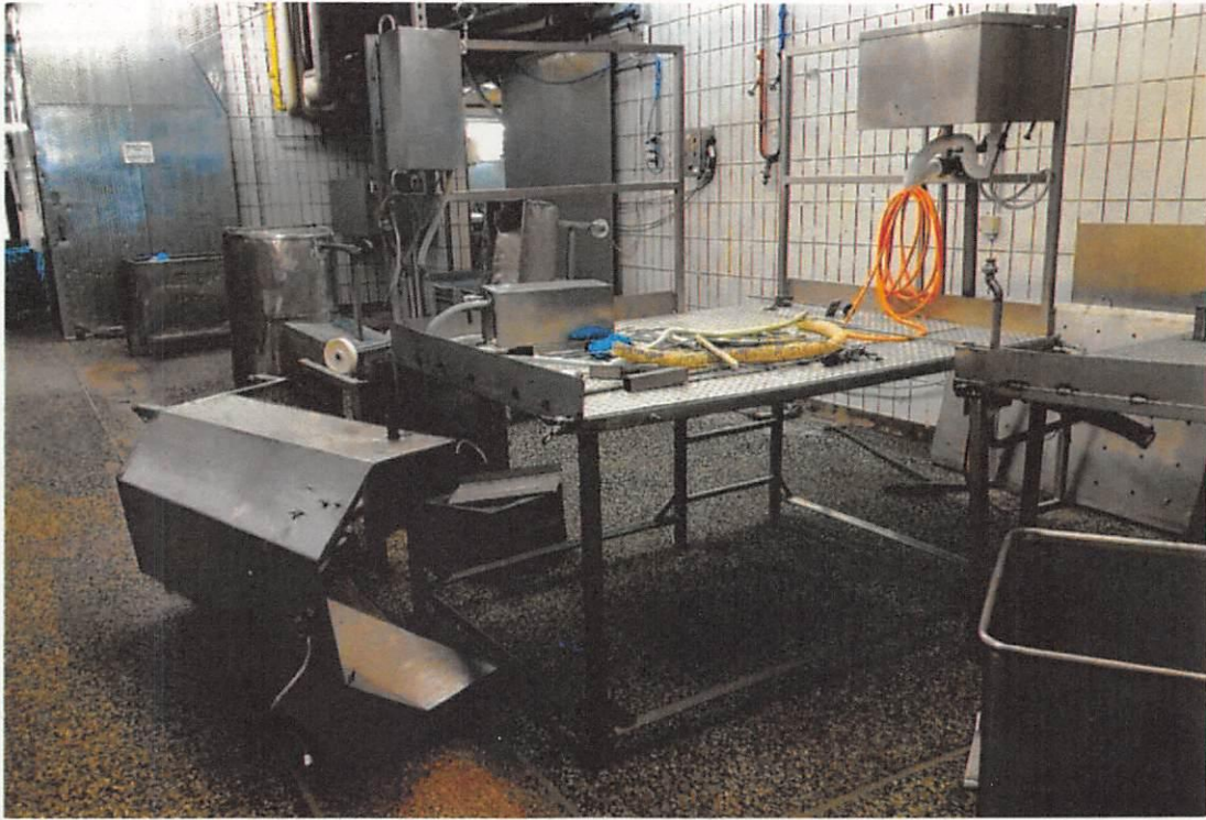
Ungenutzte Podeste mit aufliegendem Schrott. Unter anderem, alte verschmutzte Schläuche im reinem Bereich.
