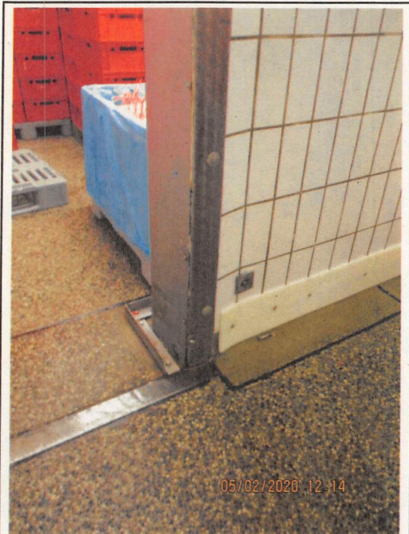
Alter „Zweier“: Blech / Eckkantenschutz an der Türzarge defekt
