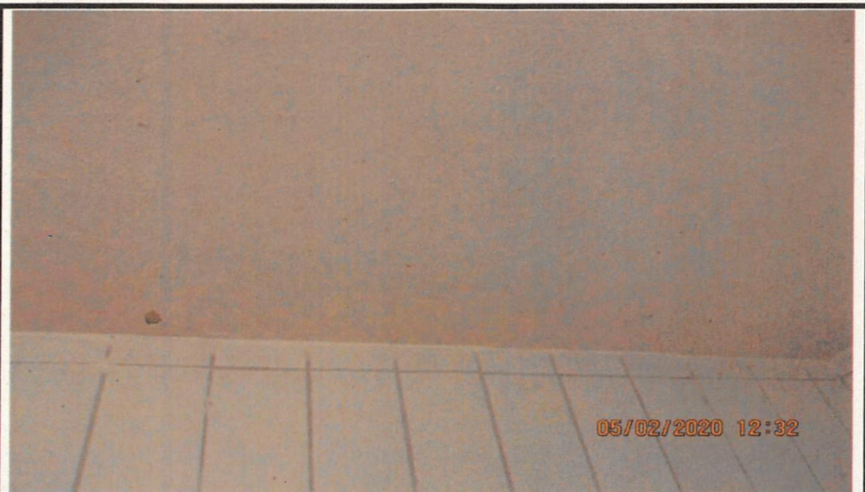
Hygieneschleuse Verladung: Decke verschmutzt mit beginnenden Farbabplatzungen
