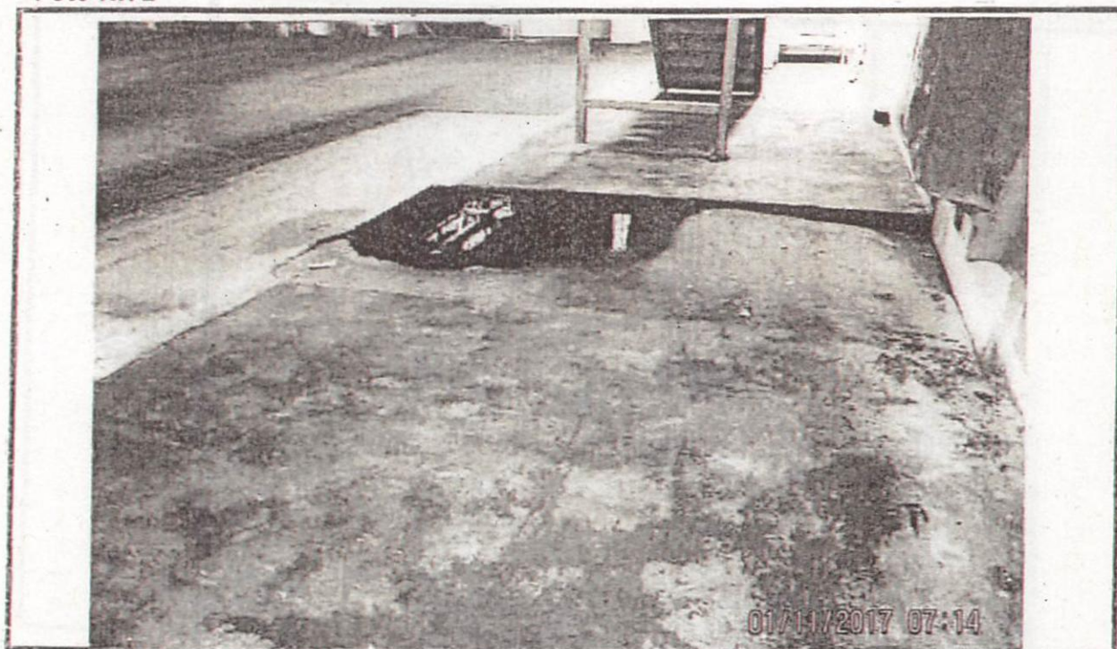
Tropfwasserlache unter dem Elevator
