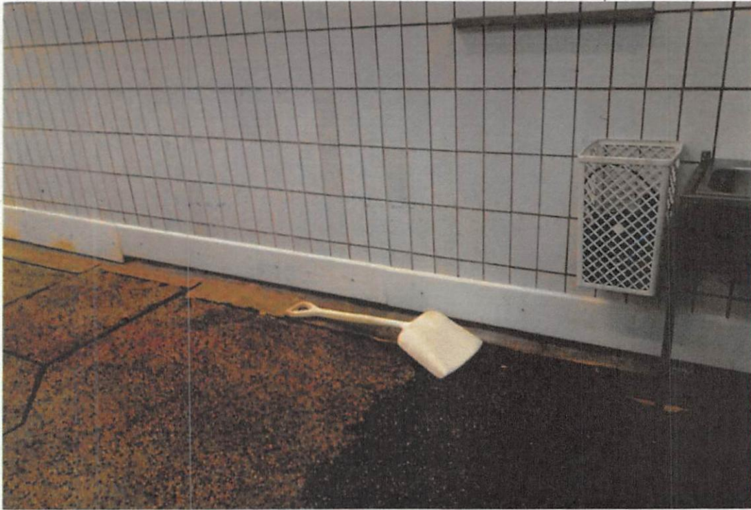
Kühlraum, Lebensmittelschaufel auf dem Fußboden
