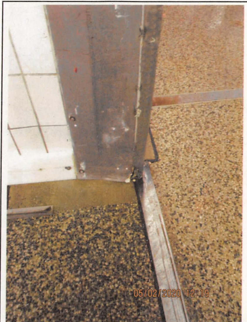
Alter „Zweier“: Blech an der Türzarge beschädigt
