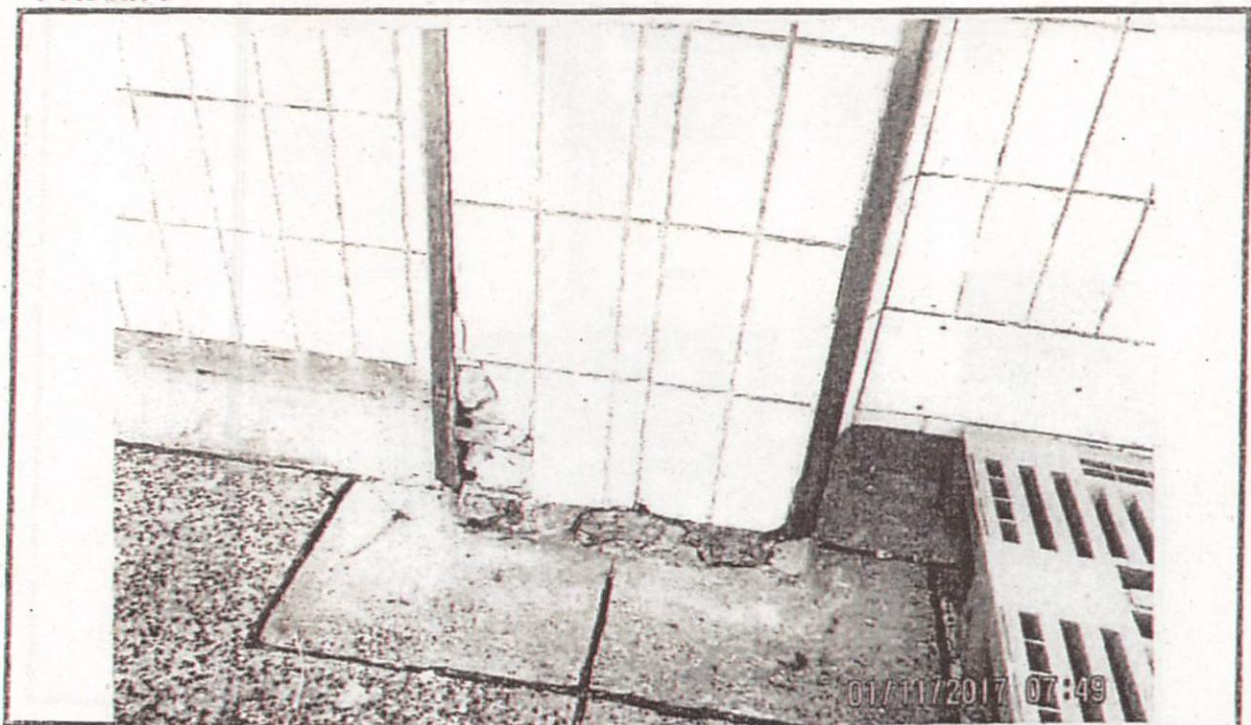
Defekte Fliesen und defekte Hohlkehle im Kühlraum für Nebenprodukte der Schlachtung
