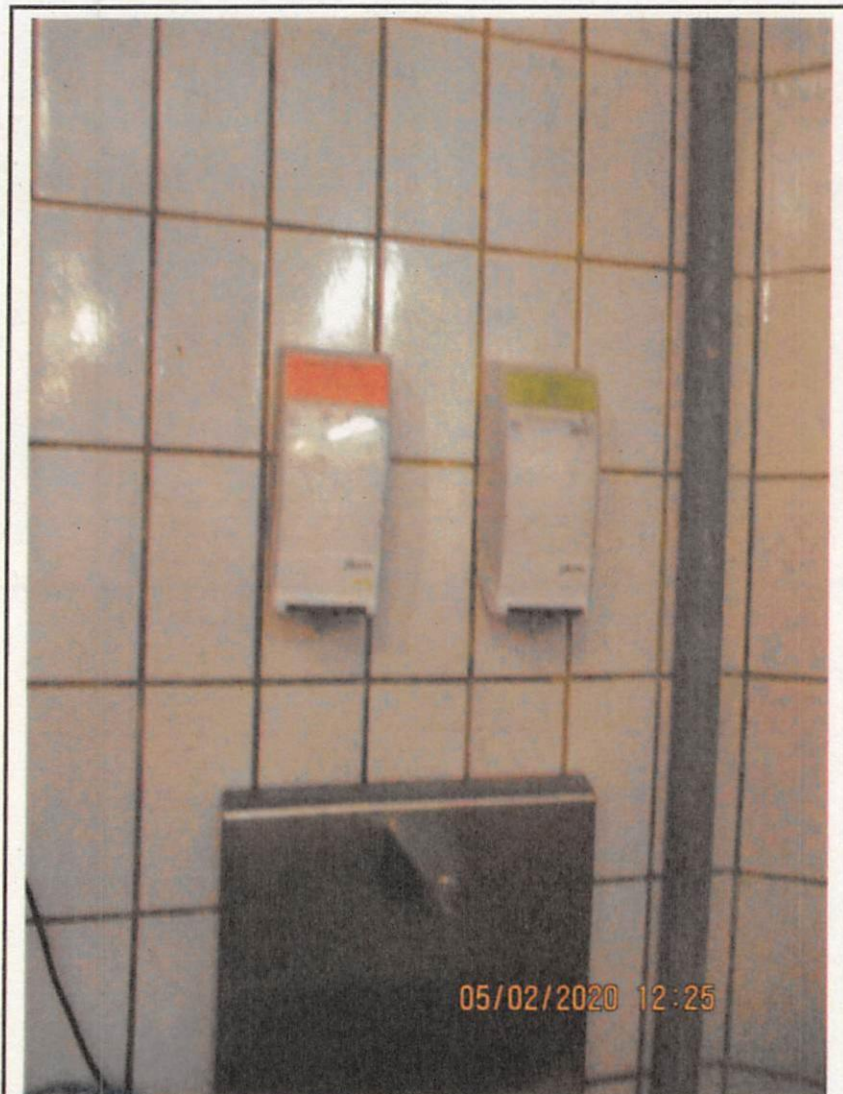
„BU-Bunker“: Handwaschbecken und Desinfektionsspender verschmutzt / außer Funktion!
