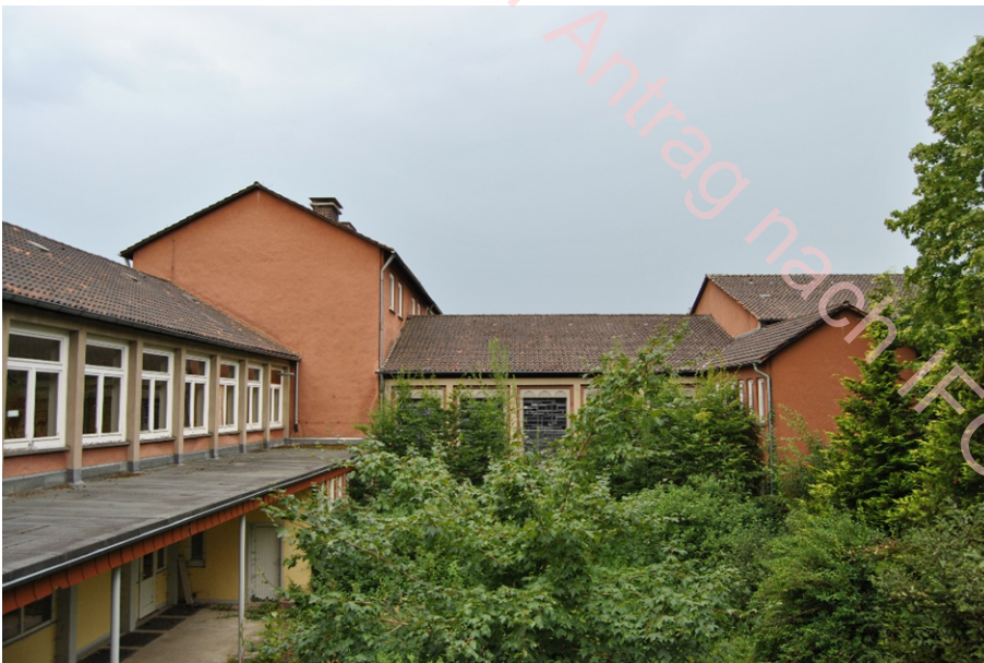
Schul- und Internatstrakt von Nordwesten, im Zentrum die Kreuzkirche mit dem erhöhten Dach über der Altarzone und der Sakristei; links unten das Vordach des Schultrakts, 2020 (LWL-DLBW/Stegmann)
