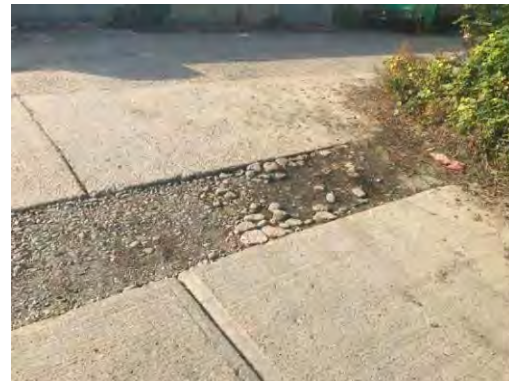
Schadstelle, bei trockener Fahrbahn
