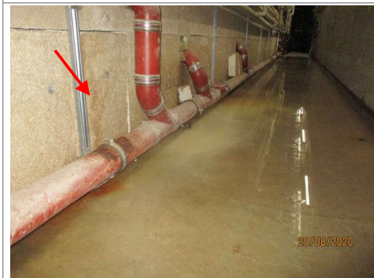
Abbildung 12: Versorgungsgang hinter dem Anschlussraum. Hier steht der gesamte Gang seit längerem unter Wasser. Sichtbar sind die bereits aufgetretenden Schäden an der HWL-Dämmung. Auch das Mauerwerk dahinter ist bis ca. 50 cm Höhe feucht.
