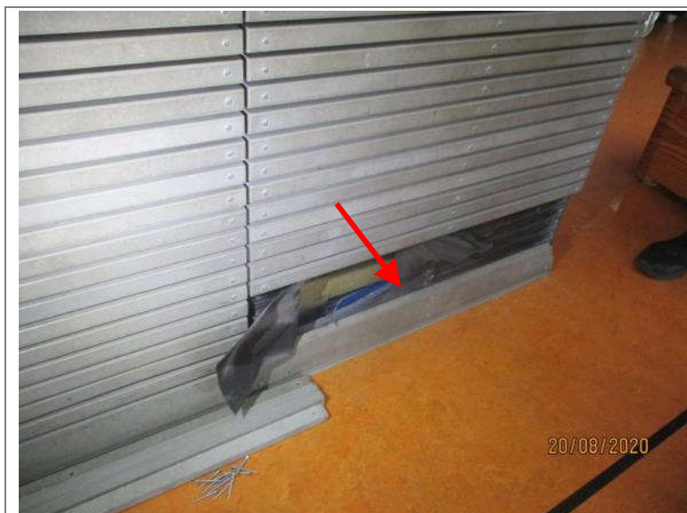
Abbildung 10: Öffnung der Wandpanele zur Untersuchung der dahinter liegenden Dämmung und des Fußbodenaufbaus
