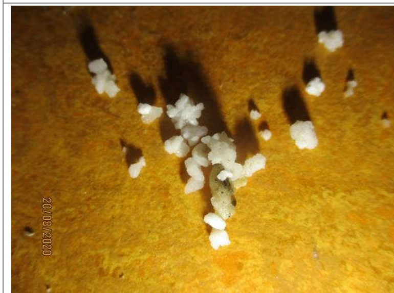
Abbildung 11: Detail des weißen Granulats zwischen Rohfußboden und der Dämmschicht aus expandiertem Schaumpolystyrol. Das eigentlich körnige Material ist durch die enthaltene Feuchtigkeit verklebt und augenscheinlich durchnässt.
