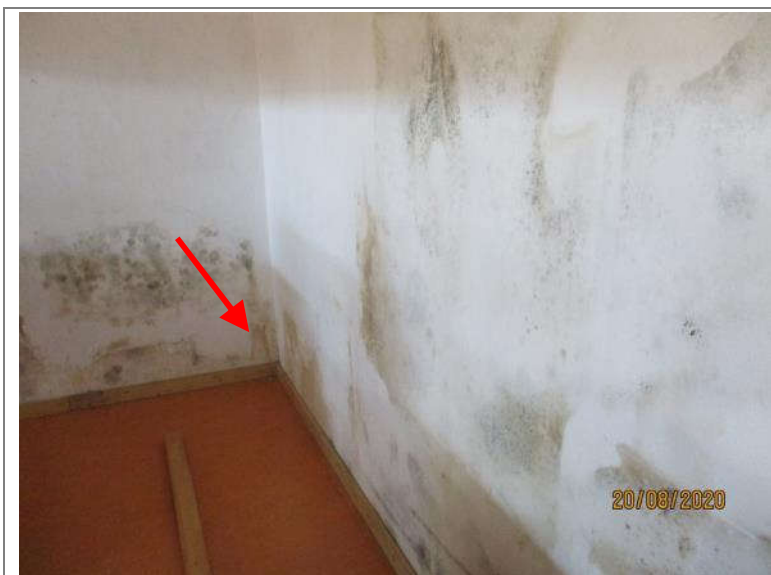
Abbildung 4: Probenahmestelle FK-02; Hinterer linke Ecke im Geräteraum mit zahlreichen Befallsstellen.
