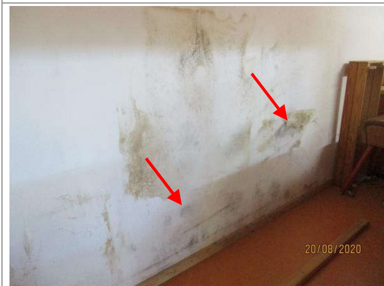
Abbildung 6: Probenahmestelle FK-03 und FK-04; Hinterer Leichtbauwand mit großflächigen Befallsstellen.
