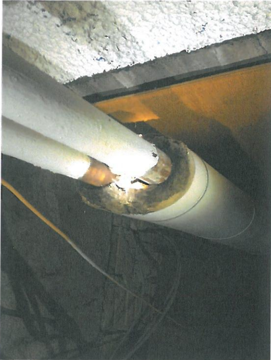
Foto-Nr. 01 – Ansicht Rohrisolierung Vorraum Planetarium im Erdgeschoss, links (06108 Halle, Peißnitzinsel 4a, ehem. „Raumflugplanetarium“)
