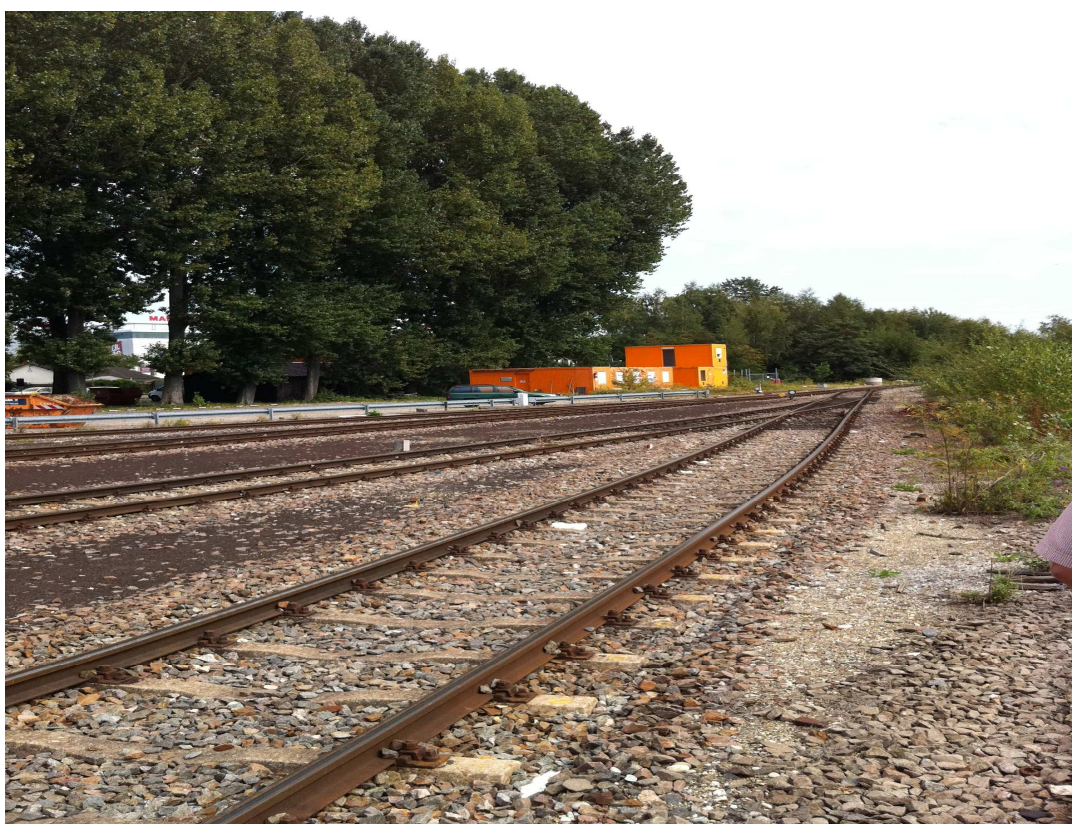
Zuführungsgleise Maschinenpool Halle
