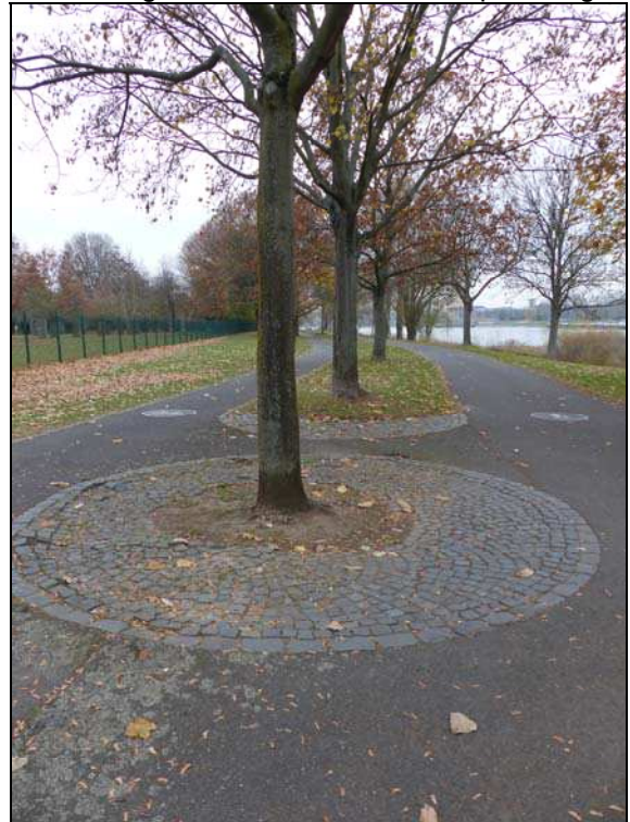
Abb. 6: Baum Nr. 806 Spitz-Ahorn mit starker Verwerfung d. Pflasterfläche u. d. Asphaltweges
