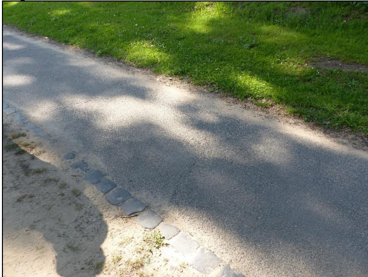
Abb. 5: Hebung des Radweges durch Wurzeln Baum Nr. 63 (Silber-Weide), Wurzelbehandlungsmaßnahmen erforderlich
