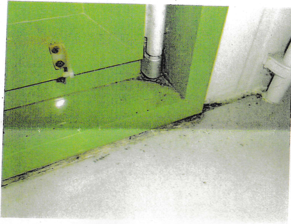
Schimmelpilzbildung am unterste Fensterkante – Kunstdarmraum
