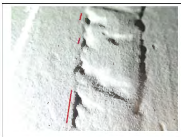
Bild 17: Mangelhafte Schweißnaht (Nahtgefüge nicht vollständig gefüllt)
