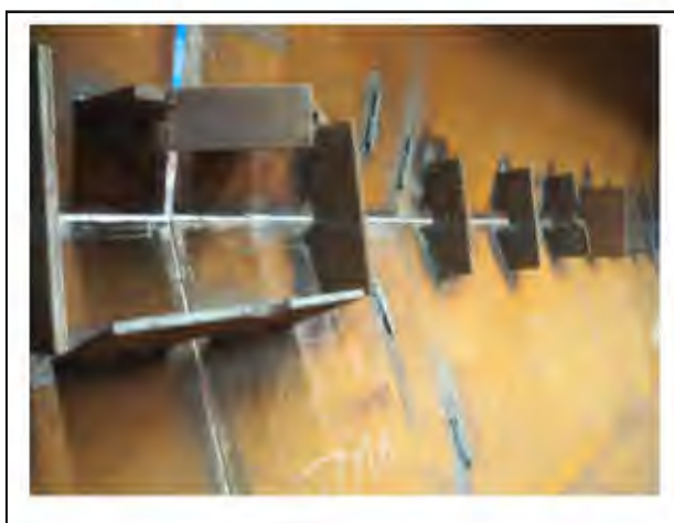
Bild 11: Nicht normgerechte Montagebleche bzw. Schädigung nach Entfernung
