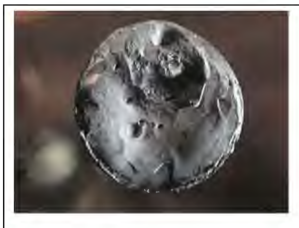
Bild 5: Mangelhafte Schweißverbindung eines Kopfbolzendübels (nach dem Entfernen des KBD)
