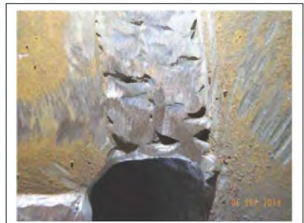
Bild 16: Mangelhafte Untergrundvorbereitung für Korrosionsbeschichtung (Mangelnde Ebenheit und offene Poren)
