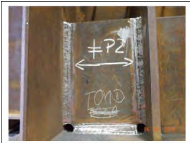
Bild 15: Mangelhafte Untergrundvorbereitung für Korrosionsbeschichtung
