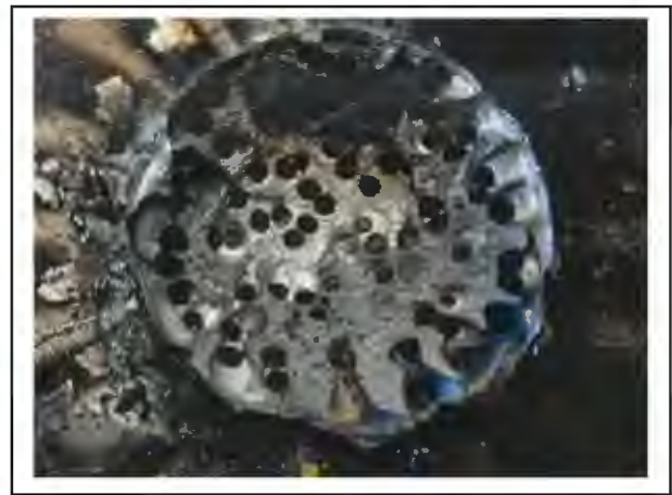
Bild 4: Mangelhafte Schweißverbindung eines Kopfbolzendübels (nach Entfernung des KBD)
