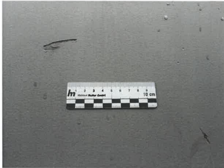
Abb. 65, Bereich AW1 außen / Anhang 19, Position 74
