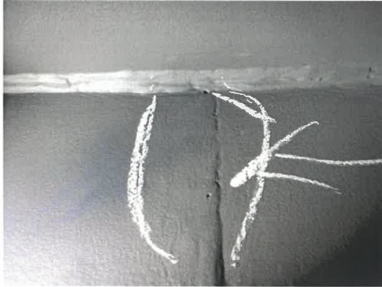
Die vorstehende Abbildung zeigt Oberflächenunregelmäßigkeiten gemäß ZTV-ING / EN ISO 8501-3: - Abweichung Vorbereitungsgrad P3 / Poren in der Schweißnaht.
