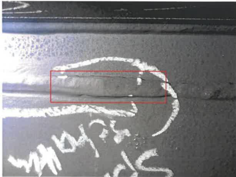
Die vorstehende Abbildung zeigt Oberflächenunregelmäßigkeiten gemäß ZTV-ING / EN ISO 8501-3: - Abweichung Vorbereitungsgrad P3 / scharfe Kante an der Schweißnaht mit Spritzschatten.
