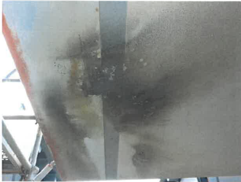
Abb. 67, Bereich AB1/ AB2 außen / Anhang 19, Position 76
