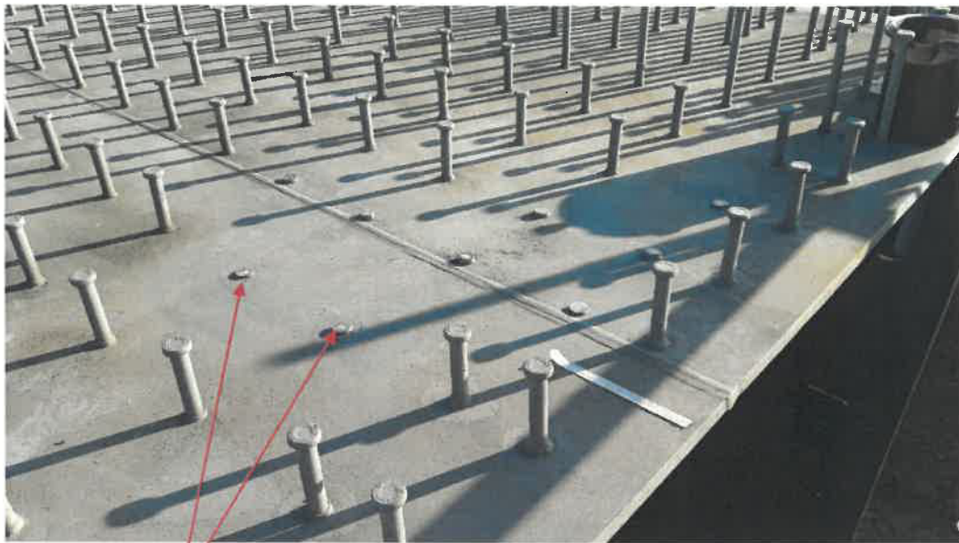
detached bolts / abgetrennte Bolzen
