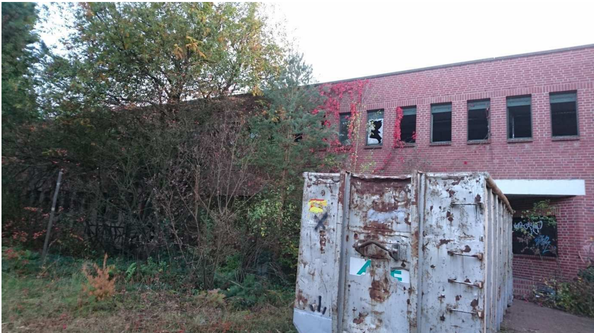
Abb. 9: zerschlagene Fenster im Verwaltungsgebäude
