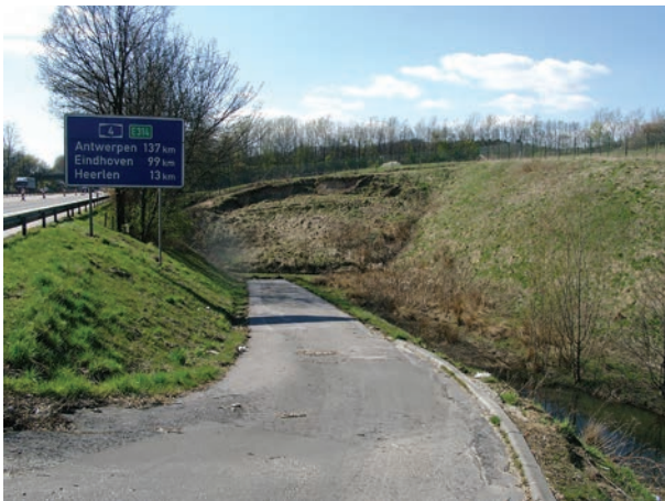
Abbildung 10: Rutschung einer Böschung
