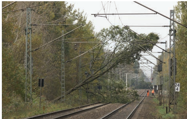
Abbildung 8: Beschädigung von Oberleitungen durch Windwurf
