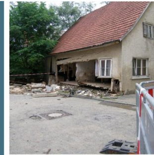
Abb. 1: Folgen einer Überschwemmung im schwäbischen Hechingen
