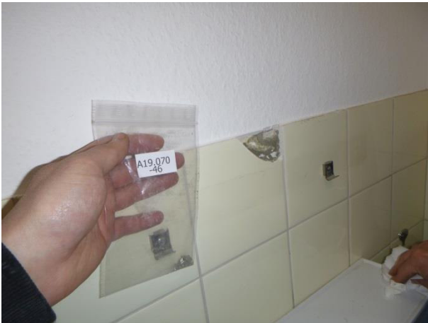
Abb. 4: Ansicht Fliesen mit asbesthaltigen Kleber z.B. in Raum 101
