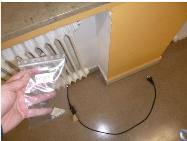
Abb. 10: Ansicht asbesthaltiger Linoleum- Belag mit asbesthaltigen Kleber
