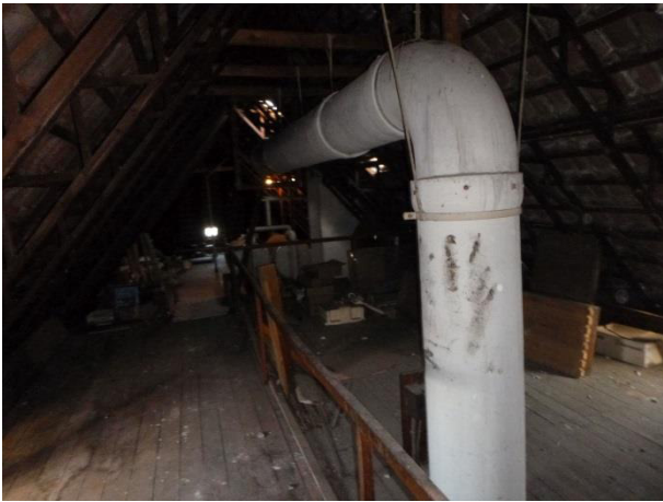
Abb.5: Ansicht AZ-Rohr, Probe A19.070-3
