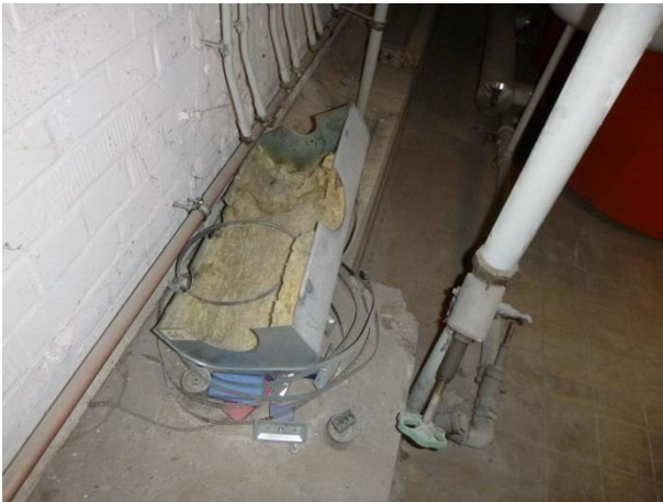
Abb. 15: Rohrisolierung unter Blech
