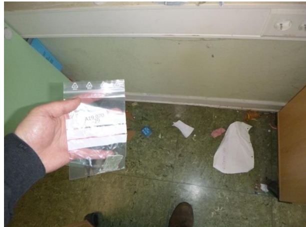
Abb.9: Ansicht PVC-Belag mit asbesthaltigen Kleber
