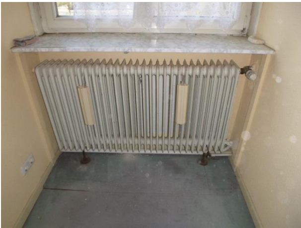
Abb. 3: Rippenheizkörper z.B. ehem. Hausmeisterwhg.
