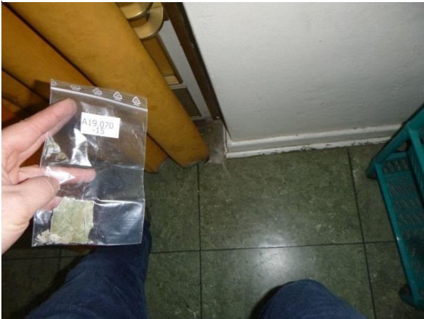
Abb.8: Ansicht PVC-Belag mit asbesthaltigen Kleber
