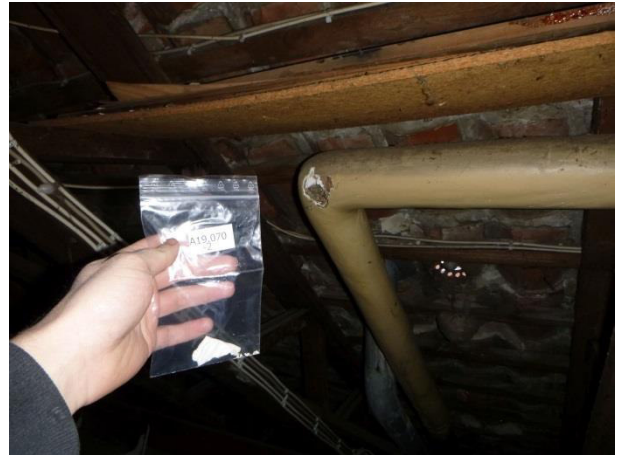
Abb. 14: Rohrisolierung unter Gipshartsschale
