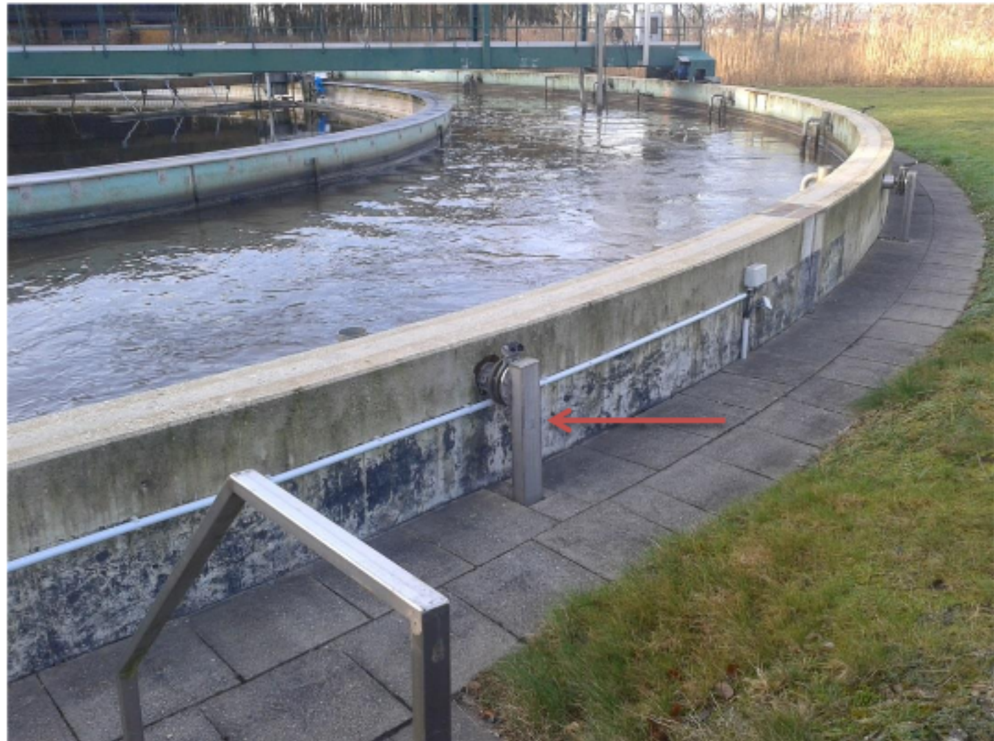
Abbildung 3: Belebungsbecken, Anschluss an die Ringleitung und Wanddurchführung
