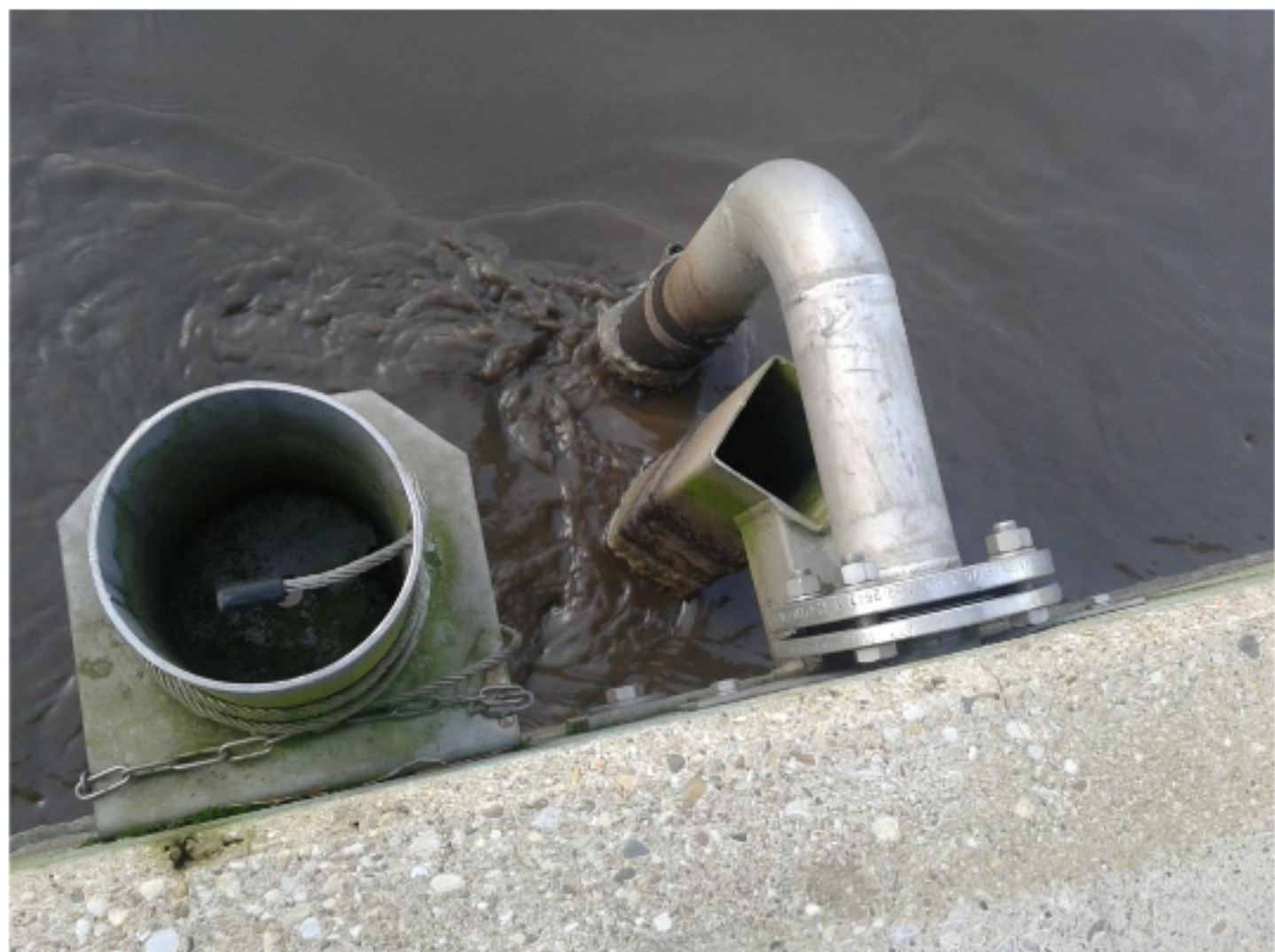
Abbildung 4: Luftleitung und Führungsrohr
