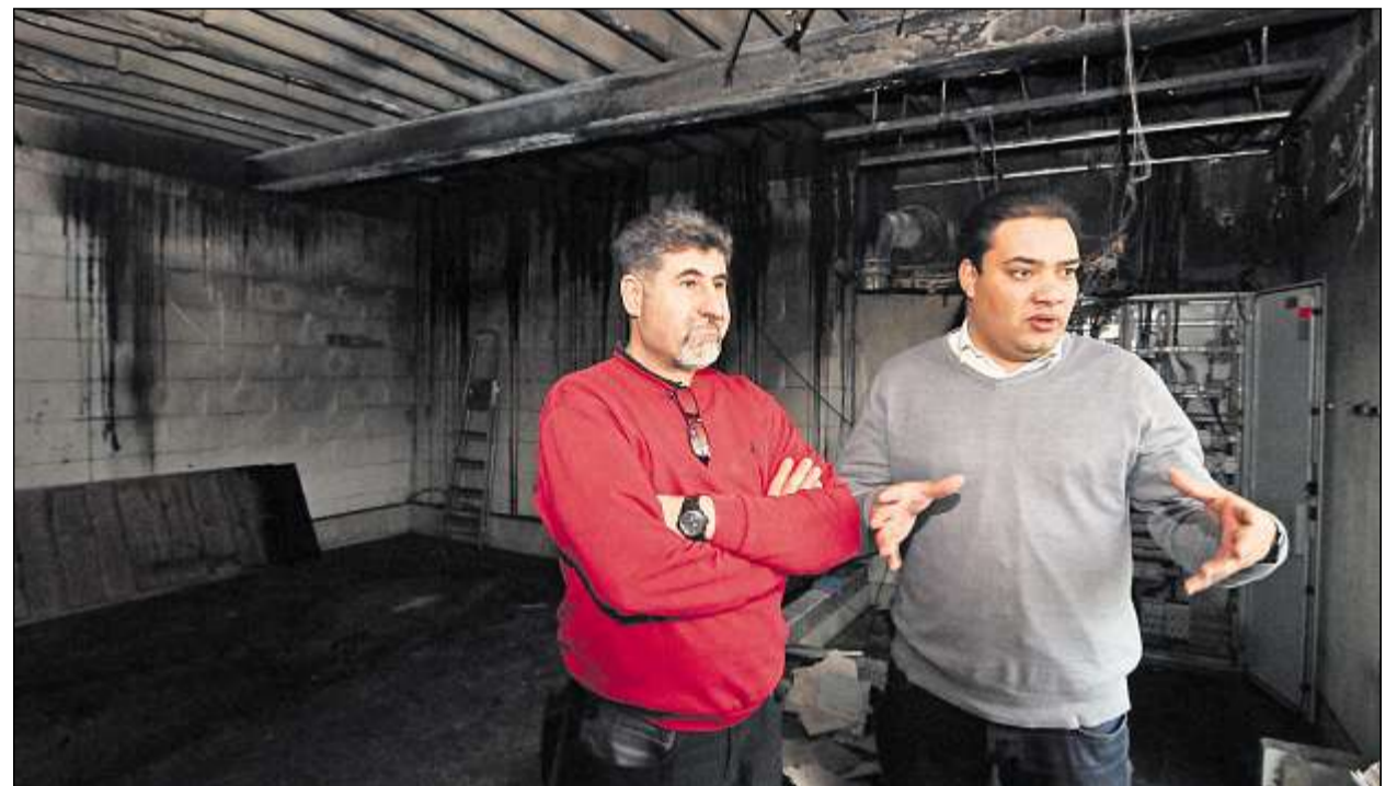
Die ausgebrannte Sauna ist mittlerweile rückgebaut. Ein Teil der Wände wird erneuert, auch das Trapezblechdach muss ausgetauscht werden, sagen Brandsanierer Senol Gider (links) und Projektleiter Sebastian Poppek. Fotos: Ralf Münch
