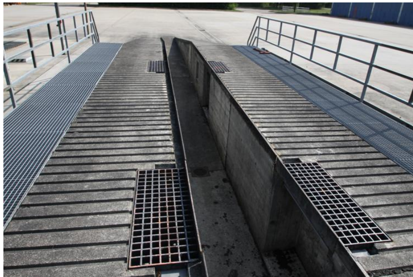
Abbildung 7-11: Abschmierrampe ohne erkennbare Verunreinigungen.
