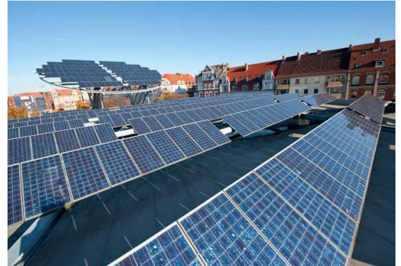
Solarstromanlage auf dem Kulturzentrum Pavillon an der Lister Meile.
