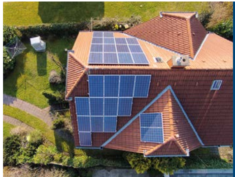
Solarthermiekollektoren auf dem Dach
