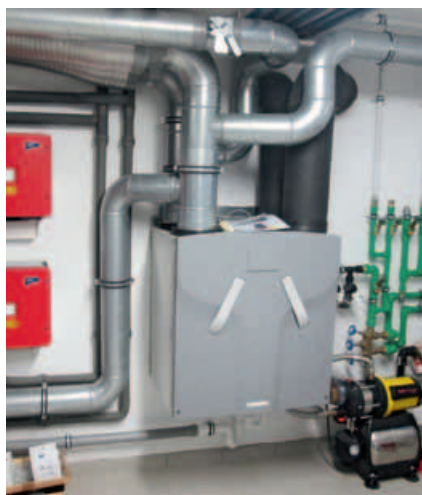
Lüftungsanlage in einem Zweifamilienhaus
