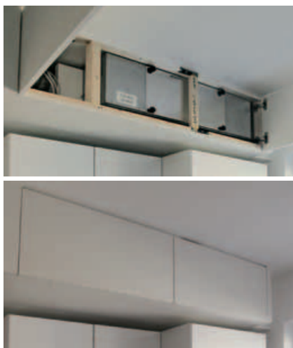
Wohnungslüftungsanlage über der Küchenzeile im Mehrfamilienhaus
