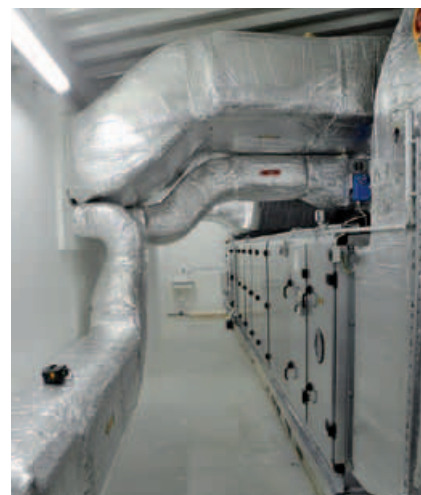
Zentrale Lüftungsanlage in einer Schule
