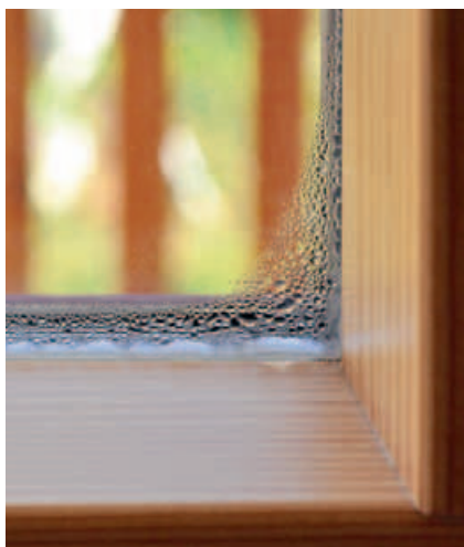
Tauwasserausfall in Höhe des Abstandhalters
