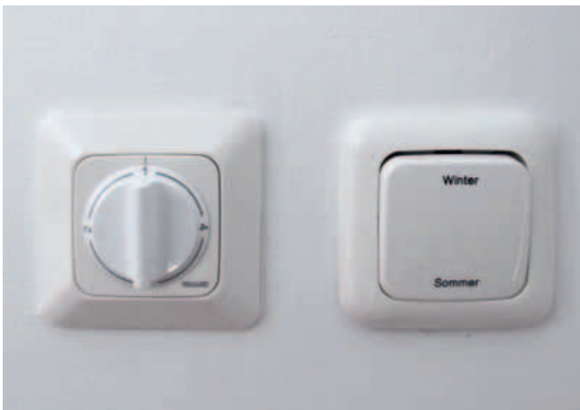
Bedienelemente der Lüftungsanlage
